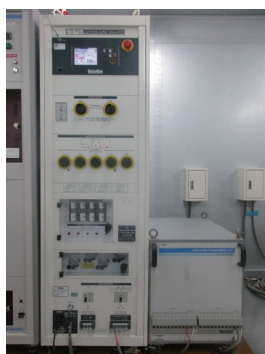
雷サージ試験機 / 絶縁トランス
