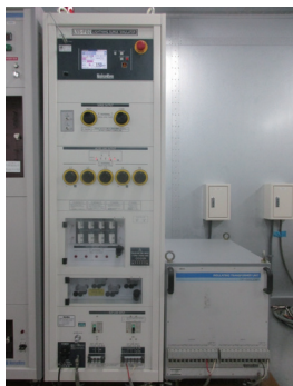
雷サージ試験機/絶縁トランス
